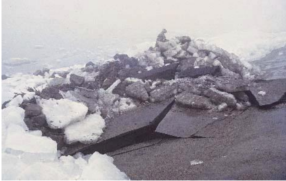
Figuur 1 Schade door kruierend ijs aan de asfaltbekleding van de Houtribdijk.
