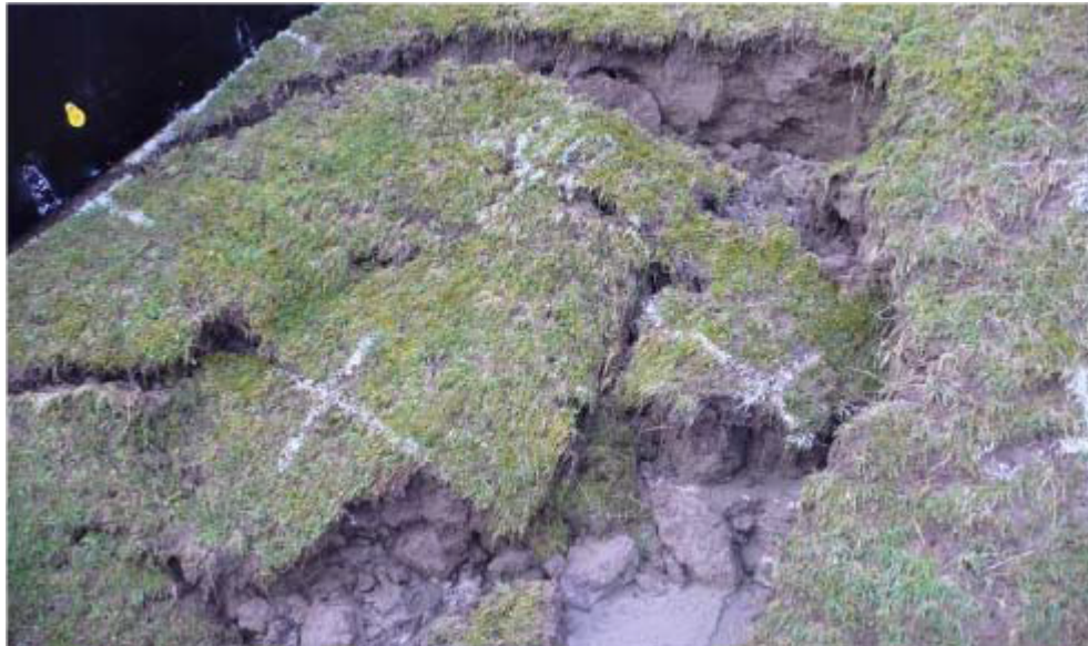
Figuur 7 Falen van de bekleding, Golfoverslagproef Tholen.
