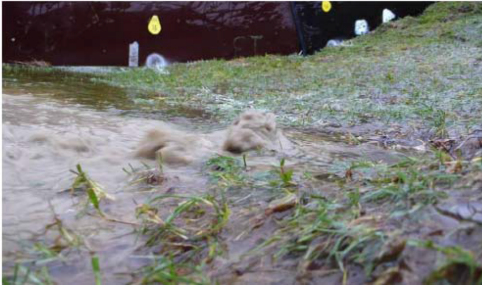
Figuur 5 Uitspoelen van zand door een mollengang onderaan het talud, Golfoverslagproef Tholen.
