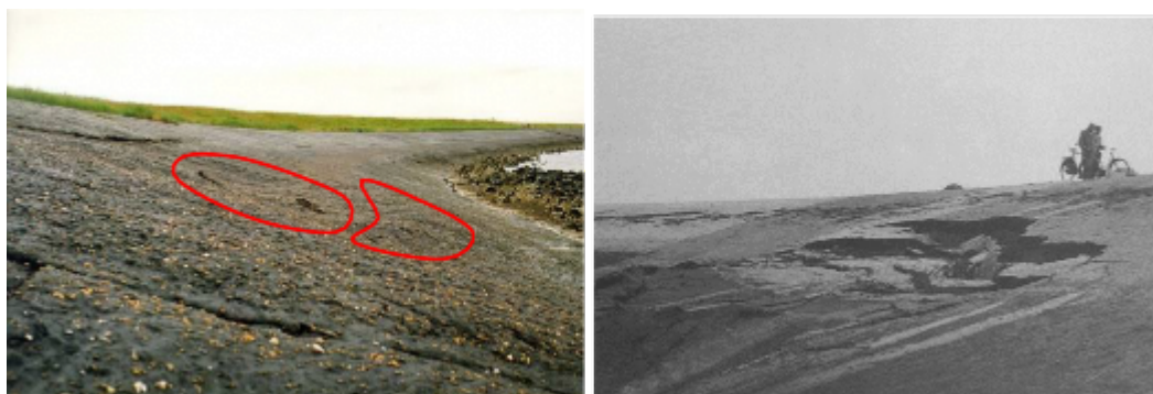
Figuur 10 Voorbeelden van instabiliteit van ondergrond.
