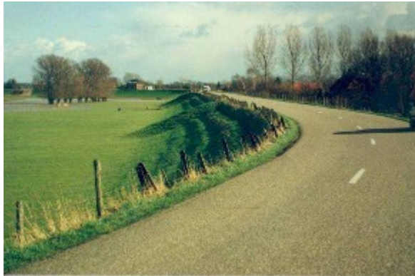
Figuur 4 Schade door methode van aanleg.
