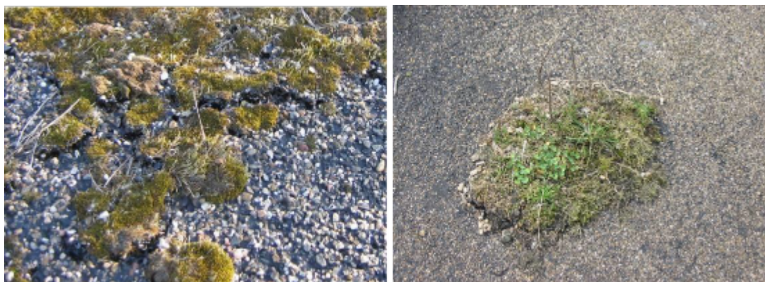
Figuur 12 Begroeiing op asfalt. Links: overgroeiing met mos. Rechts: kluit met begroeiing die los op bekleding ligt.
