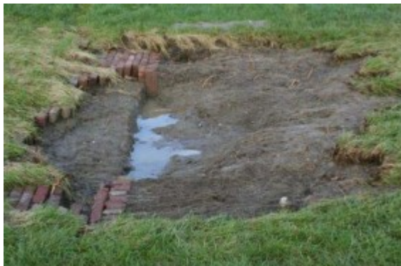
Figuur 2 Jet-erosie bij de overgang van een talud naar horizontaal.
