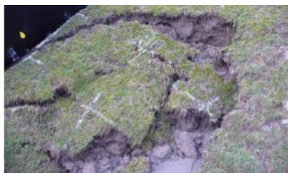
Figuur 2 Ongewenste combinatie van een slechte grasmat, een dunne kleilaag en graverij waardoor ondermijning van de kleibekleding optreedt. Zeedijk nabij Poortvliet op Tholen.
