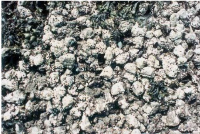
Figuur 2 Biologische aantasting van open steenasfalt door zeepokken op Neeltje Jans, 1989. (Foto: Oranjewoud).
