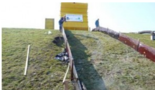
Figuur 3 Ongewenste combinatie van een slechte grasmat, een dunne kleilaag en graverij waardoor ondermijning van de kleibekleding optreedt. Zeedijk nabij Poortvliet op Tholen.
