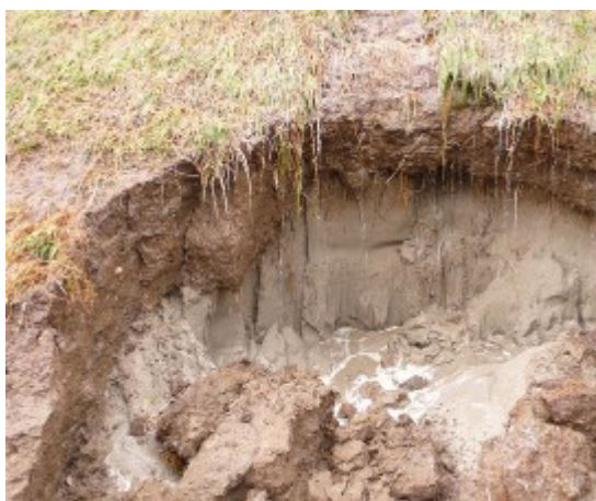
Figuur 2 Head cut erosie bij zanddijk met kleibekleding Sint Philipsland.
