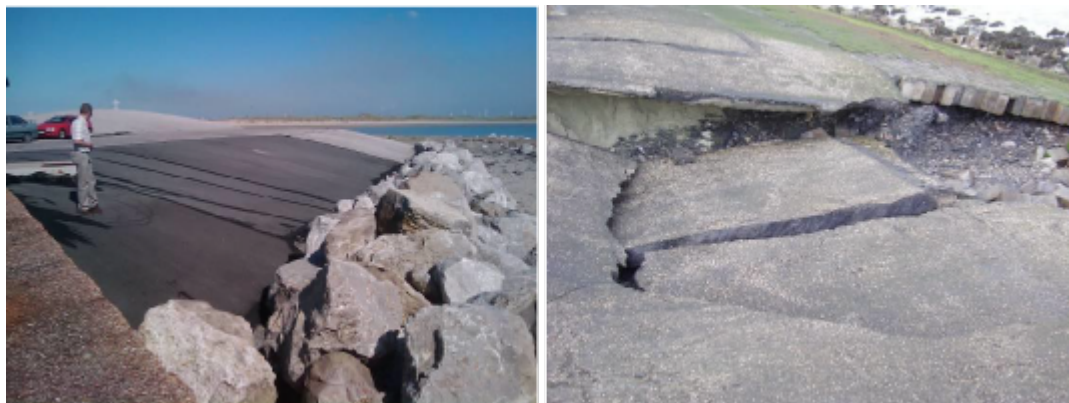
Figuur 4: Links: lokaal vervangen bekleding na schade door uitspoelen van zand bij een slecht uitgevoerde aansluiting op de betonnen constructie links. Rechts: gat na het instorten van de toplaag na ondermijning als gevolg van het bezwijken van de aangrenzende steenzetting.
