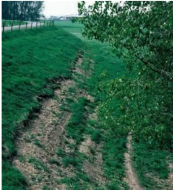
Figuur 3 Eerdere schade buitentalud bij golfaanval.
