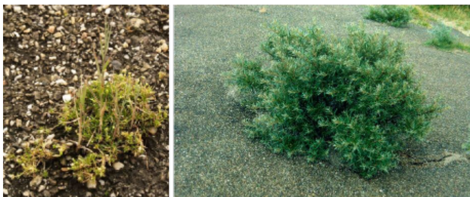
Figuur 13 Links: begroeiing in de bekleding (riet en spurrie). Rechts: begroeiing (duindoorn, struik) door de bekleding.
