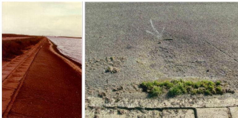
Figuur 11 Links: zakking als gevolg van zettingen van de ondergrond. Rechts: zakking als gevolg van uitspoeling, in dit geval via de onderste overgangsconstructie. Let ook op de verzakte blokken onder in beeld.
