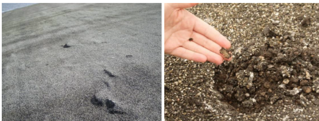
Figuur 8 Links: enkele zeer prominente opbollingen; rechts: open gebroken opbolling toont lokaal volledig uiteengevallen grindasfalt.
