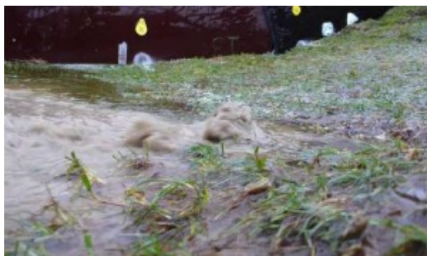
Figuur 1 Ongewenste combinatie van een slechte grasmat, een dunne kleilaag en graverij waardoor ondermijning van de kleibekleding optreedt. Zeedijk nabij Poortvliet op Tholen.
