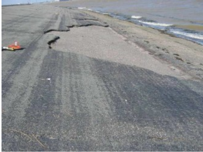
Figuur 17 Schade door loskomen later aangebrachte toplaag met onvoldoende hechting.
