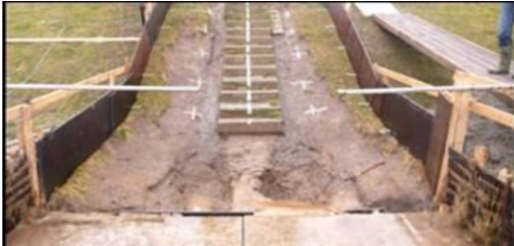
Figuur 2 Schade als gevolg van stroomconcentratie na zeer grote overslagdebieten. Golfverslagproeven Afsluitdijk, 6 uur 50 l/s per m.
