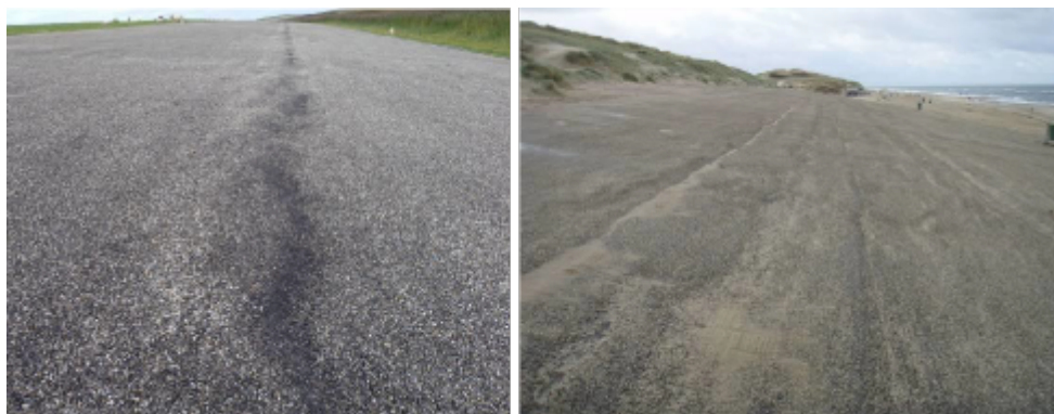
Figuur 9 Enkele strookvormige opbollingen.
