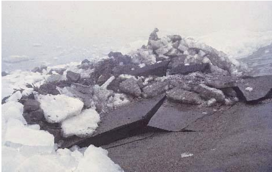
Figuur 1 Schade door kruiend ijs aan de asfaltbekleding van de Houtribdijk.
