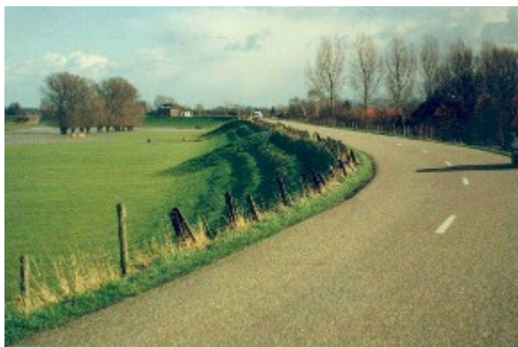
Figuur 4 Schade door methode van aanleg.
