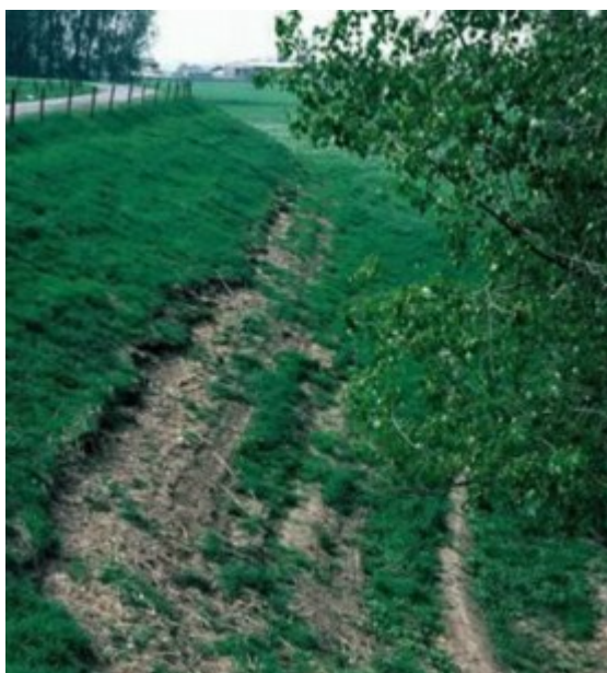
Figuur 3 Eerdere schade buitentalud bij golfaanval.
