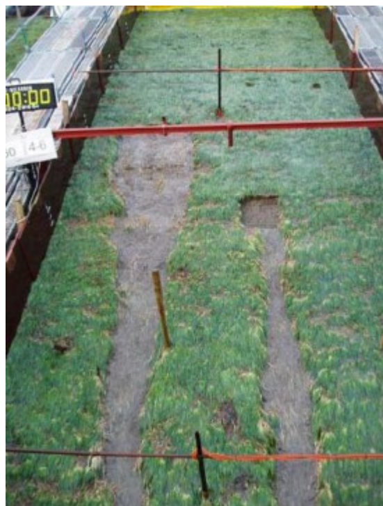
Figuur 2 Afstropen na aanbrengen van schades. Zeedijk bij Delfzijl.
