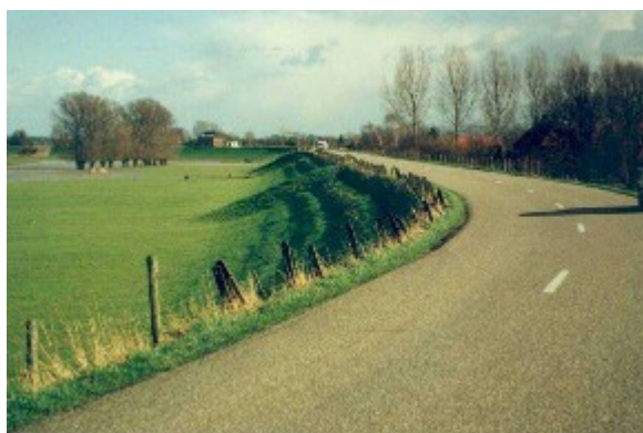
Figuur 4 Schade door methode van aanleg.
