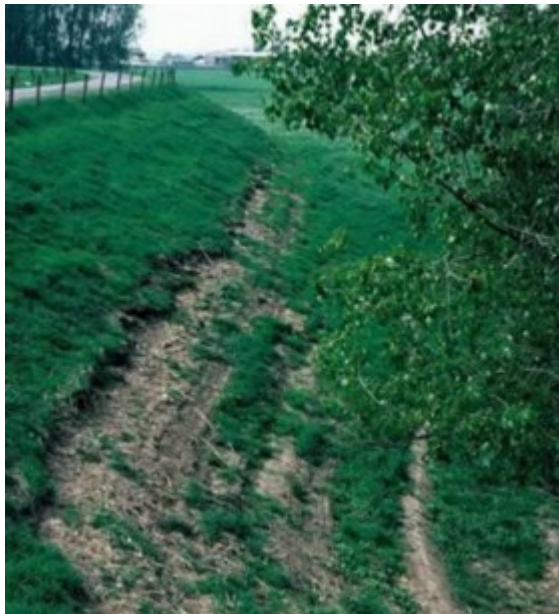
Figuur 3 Eerdere schade buitentalud bij golfaanval.
