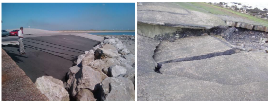
Figuur 4: Links: lokaal vervangen bekleding na schade door uitspoelen van zand bij een slecht uitgevoerde aansluiting op de betonnen constructie links. Rechts: gat na het instorten van de toplaag na ondermijning als gevolg van het bezwijken van de aangrenzende steenzetting.
