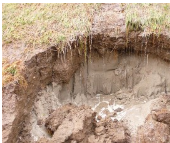
Figuur 2 Head cut erosie bij zanddijk met kleibekleding Sint Philipsland.
