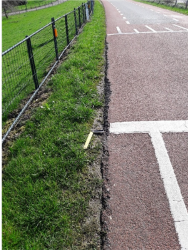
Figuur 6 Voorbeeld 'nette overgang', maar met een plaatselijk mindere kwaliteit grasbekleding (open graszode).
