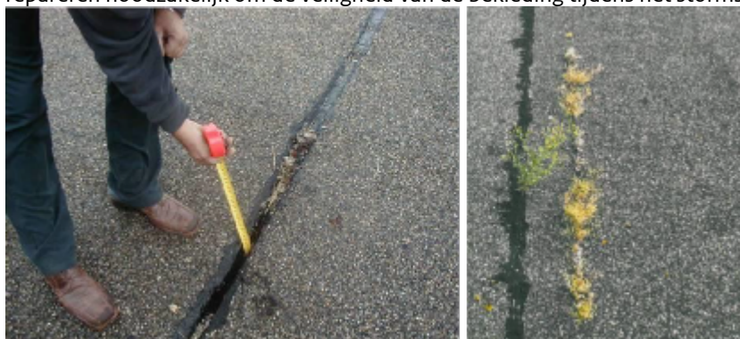
Figuur 2 Links: openstaande naad die al eerder was gevuld. Rechts: liplas met links in beeld een gevulde naad met een enkele plant en even rechts daarvan een strook vergeelde begroeiing in de scheur van de afgebroken lip (= situatie van Figuur 3 rechtsonder).
