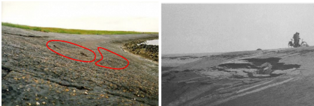
Figuur 10 Voorbeelden van instabiliteit van ondergrond.
