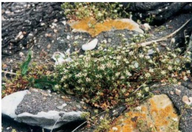
Figuur 4 Oude gietasfaltpenetratie met begroeiing op de Grevelingendam, 1996.
