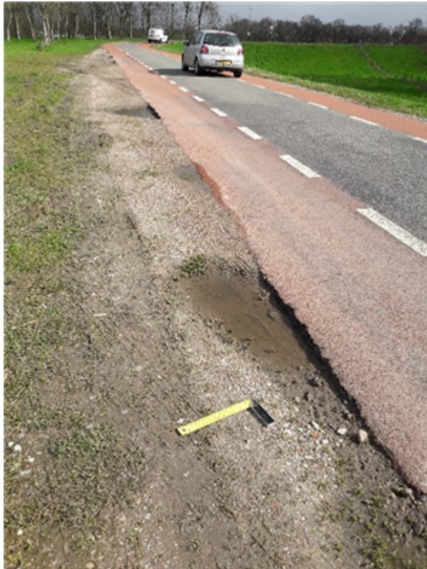
Figuur 7 Voorbeeld van een niet-nette overgang, aansluiting tussen asfalt en grasbekleding bevat grote gaten.
