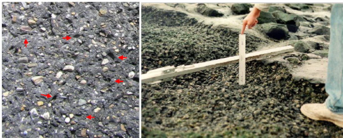
Figuur 6 Aangetast oppervlak. Links: grindasfalt aangetast door stripping, bij de pijltjes afdrucken van grindbiggels die zijn losgekomen. Rechts: open steenasfalt aangetast door erosie (mechanische belasting).
