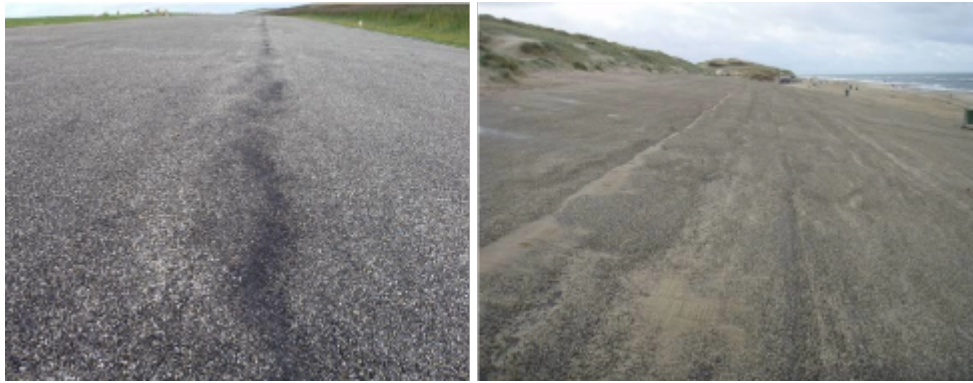
Figuur 9 Enkele strookvormige opbollingen.
