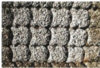
Figuur 3 Betonzuilen met ecotop.
