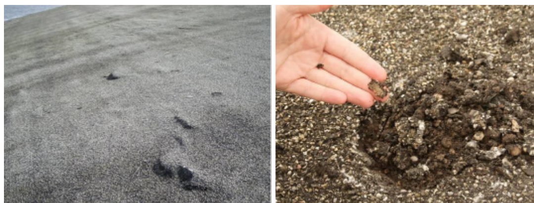
Figuur 8 Links: enkele zeer prominente opbollingen; rechts: open gebroken opbolling toont lokaal volledig uiteengevallen grindasfalt.
