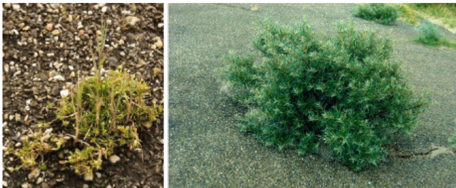
Figuur 13 Links: begroeiing in de bekleding (riet en spurrie). Rechts: begroeiing (duindoorn, struik) door de bekleding.
