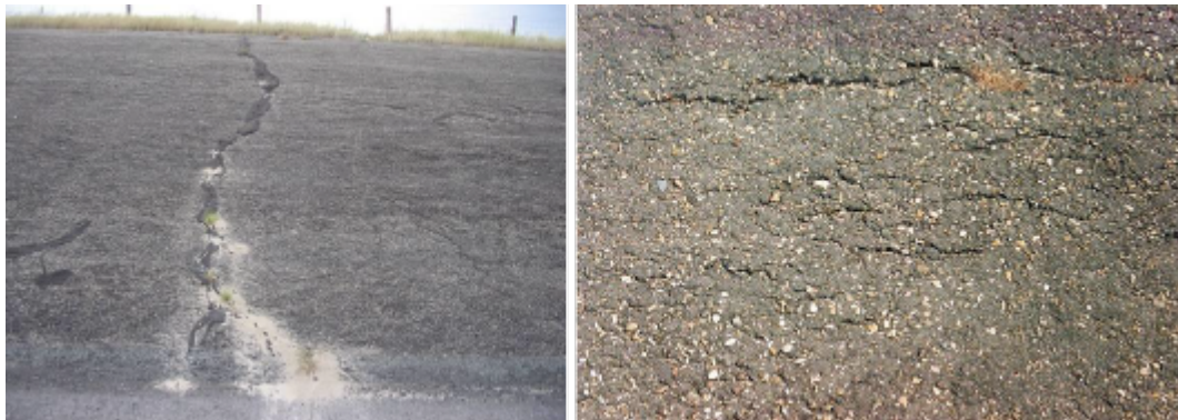
Figuur 1 Links: temperatuurscheuren waarbij zand van onder de bekleding is gekomen als gevolg van activiteit van mieren. Rechts: walscheuren.
