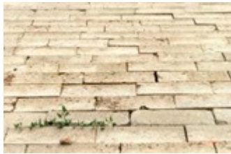
Figuur 4 Gekantelde betonblokken.
