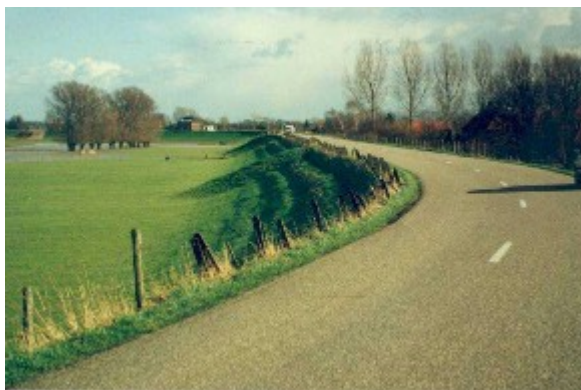
Figuur 4 Schade door methode van aanleg.
