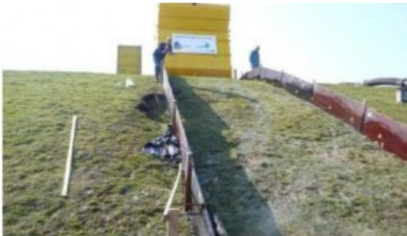
Figuur 3 Ongewenste combinatie van een slechte grasmat, een dunne kleilaag en graverij waardoor ondermijning van de kleibekleding optreedt. Zeedijk nabij Poortvliet op Tholen.
