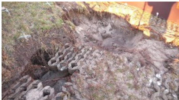
Figuur 4 Jet-erosie bij de overgang van een talud naar horizontaal.
