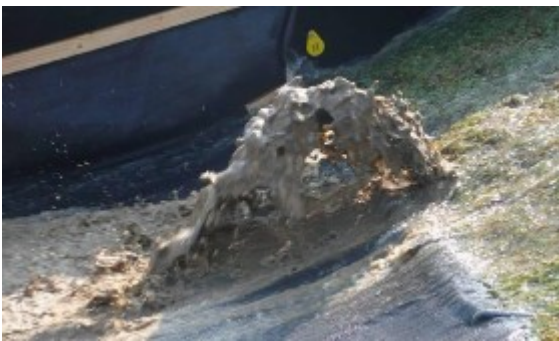
Figuur 4 Ongewenste combinatie van een slechte grasmat, een dunne kleilaag en graverij waardoor ondermijning van de kleibekleding optreedt. Zeedijk nabij Poortvliet op Tholen.
