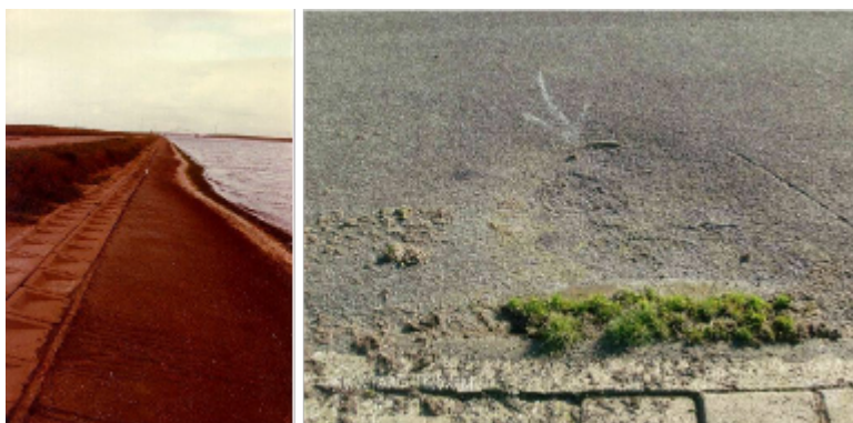
Figuur 11 Links: zakking als gevolg van zettingen van de ondergrond. Rechts: zakking als gevolg van uitspoeling, in dit geval via de onderste overgangsconstructie. Let ook op de verzakte blokken onder
